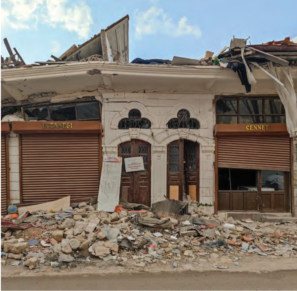
Resim 1. Üst katları yıkılmış, zemin katları ağır hasarlı Antakya Kentsel Sit Alanı Kurtuluş Caddesi üzerinde tescilli kültür varlığı (Fotoğraf: Hakan Boyacı).
