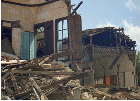
Resim 3. Antakya Kentsel Sit Alanı Kurtuluş Caddesi üzerinde ağır hasar gören tescilli kültür varlığı: Ziver Paşa Konağı (Fotoğraf: Hakan Boyacı).
