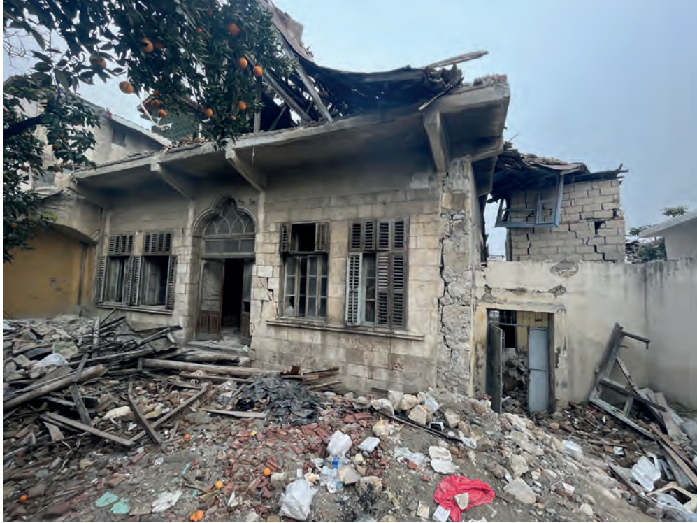
Resim 14. Antakya tarihi merkezde depremde hasar almış atipik bir örnek. Yığma taş duvar üzerine betonarme tabliye ve konsol kısımları tutan kirişler.
